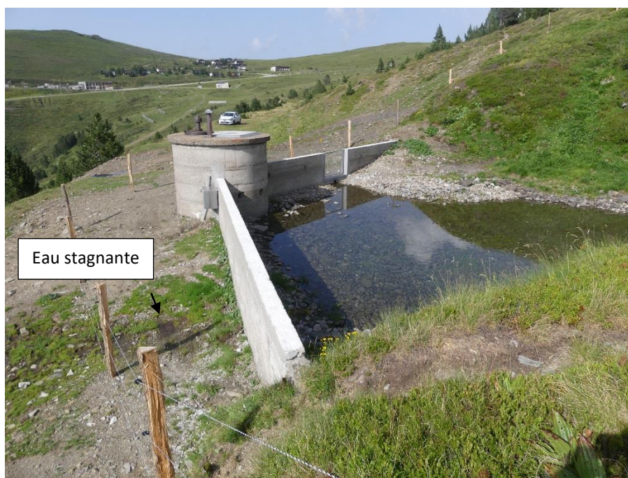
Vue du captage après les travaux d'amélioration suite à la visite du 29/06/2018
